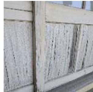
傷んだ建具の突板
